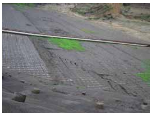
写真-2 上流斜面の変状(全景)
