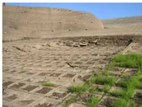
写真-3 上流斜面の変状(細部)
