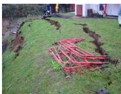
写真-4 管理棟周辺盛土部のすべり
