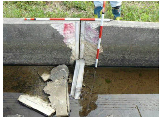
Fig.1 コンクリートおよび止水板の剥落 (Stripping of concrete and dislodging of a water stop)
