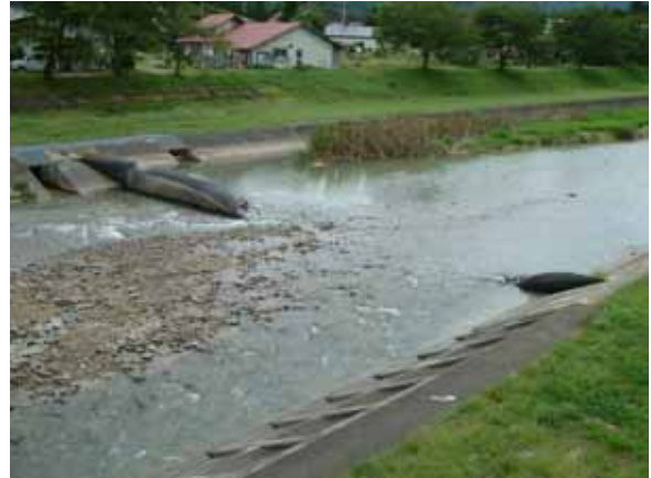
図 4 中央頭首工ゴム堰上の堆砂(2007.9)
