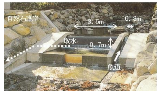
写真-1 大沢取水工（奥志賀高原） Torrent intake in Oosawa
