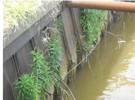
図 - 1 既設鋼矢板の腐食・欠損状況
