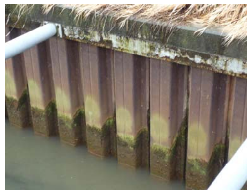
図 - 4 既存施設の腐食状況 (亀田排水路)
