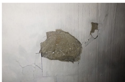
写真-1 8本目 破損状況
