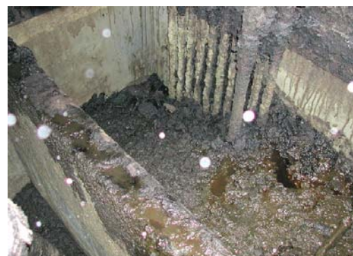
図 6 殺菌槽でのスラッジ堆積状況 Fig.6 Sludge in the sanitation tank
