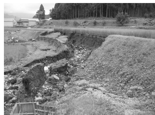
写真2 農地ののり面の崩壊 Slope break
