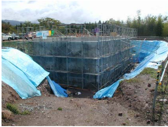
写真－１ 対象とした農業集落排水施設
