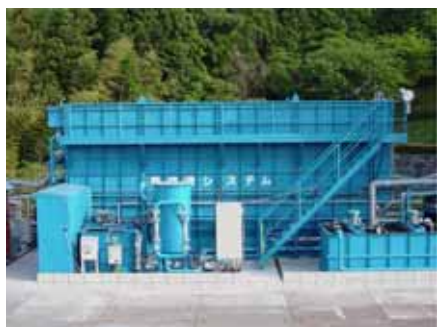
写真 - 2 処理装置
