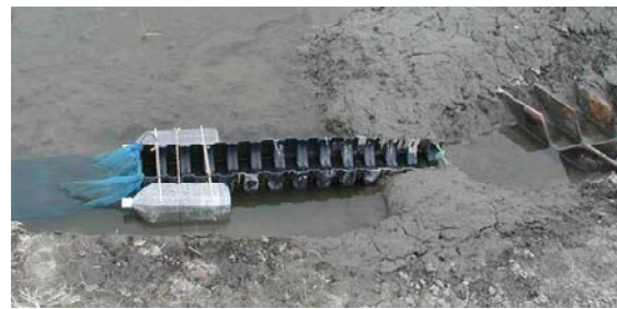
写真 1 流量調節器の設置状況
