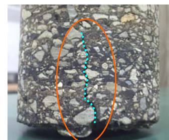
Fig.3 ひび割れ発生状況
