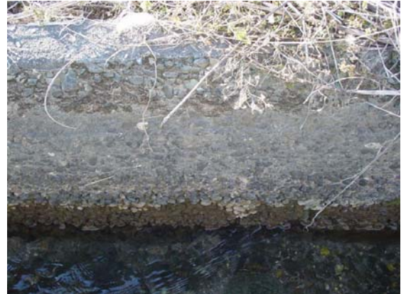
写真-1 コンクリート水路の骨材露出 Exposed coarse aggregate of concrete channel
