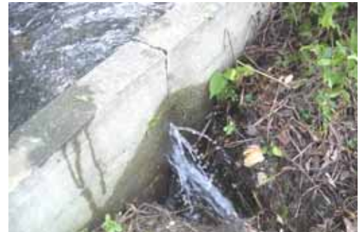
写真 - 1 目地部からの漏水 Water Leakage Example in Damaged Joint
