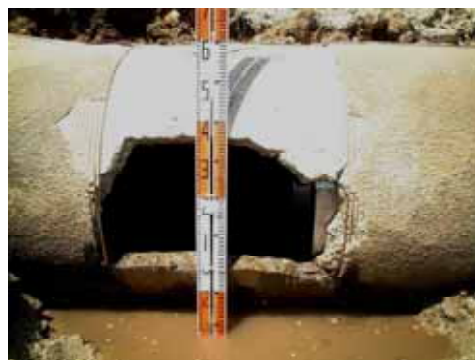
写真-1 PC管本体の破裂
