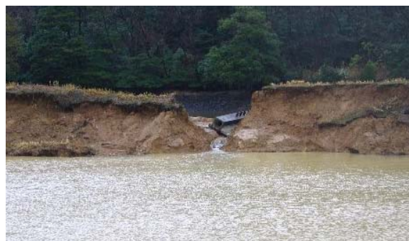
写真-1 被災状況 (下流側より)
