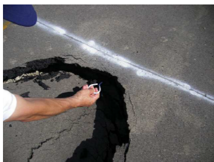
Fig.4 アスファルトの下部に発生した空洞 Hollow under asphalt
