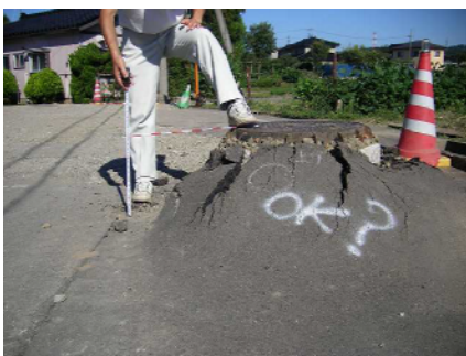
Fig.2 マンホールの浮上 Uplift of a manhole
