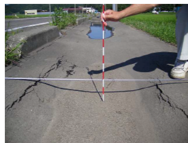
Fig.3 埋戻し部分に沿って生じた歩道での路面沈下 Settlement of sidewalk
