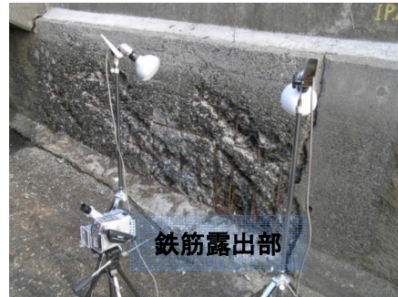
写真1 コンクリート水路壁面損傷部
