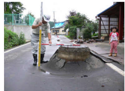
浮き上がったマンホール
