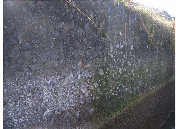
写真-1 コンクリート水路の骨材露出 Exposed coarse aggregate of concrete channel
