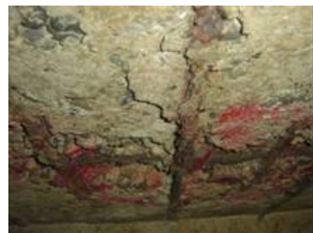
写真 1 鉄筋腐食状況
