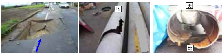
写真-1 出水による道路陥没と FRPM 管の破損事例
