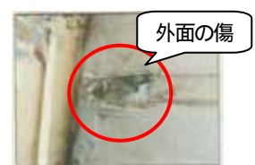
写真-5 管体外面の傷
