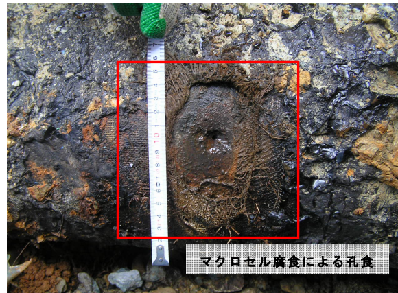
図1 鋼管のマクロセル腐食状況
