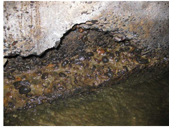
Pic. 2 老朽状況
