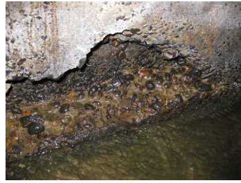
Pic. 2 老朽状況
