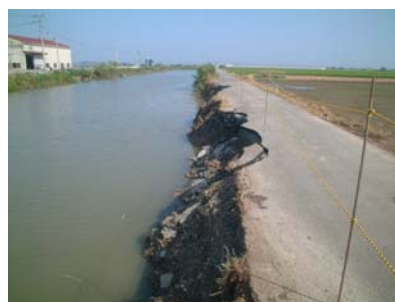
写真-1 道路損壊状況
