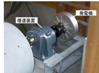
写真-2 発電機と増速装置 Generator and speed increasing gear
