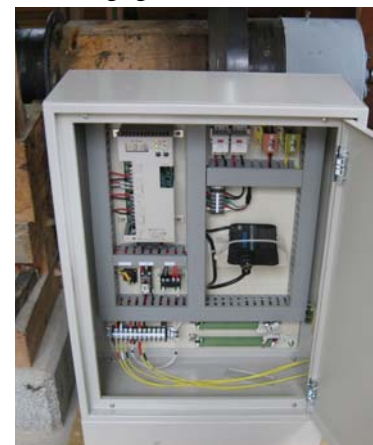
写真-3 制御装置 Control panel
