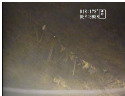
図-5 ROV で撮影した目地部からの吸い込み状況
