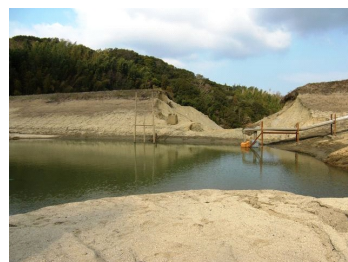
Fig. 1 ため池被災状況(2012.1.28撮影)
