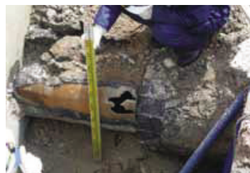
写真-1 破損状況
