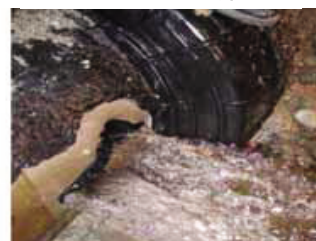
写真-2 漏水状況
