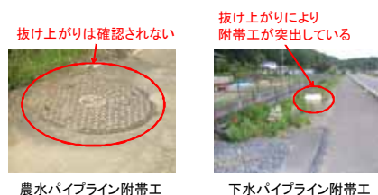
写真1 マンホールの抜け上がり状況
