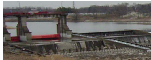
図1 堰直下の段差発生事例 Downstream drop of a barrage
