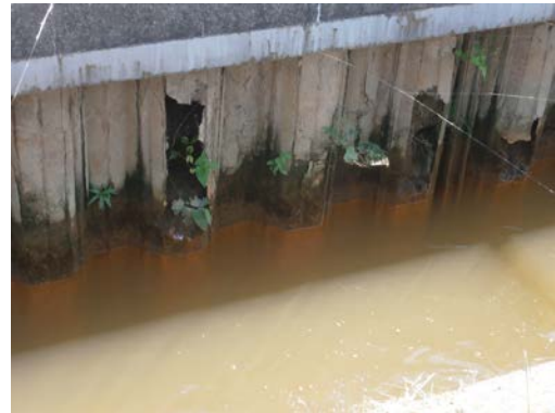
図 - 1 既設鋼矢板の腐食・欠損状況
