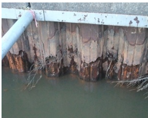
図 - 4 既存施設の腐食状況（海老ヶ瀬排水路）
