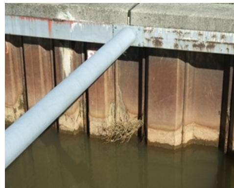
図 - 5 既存施設の腐食状況（早通排水路）
