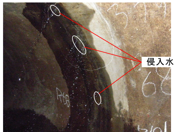
写真 1 サイホン内への侵入水
