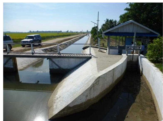
写真1 落差工と小水力発電設備 Photo1. Drop structure & Small-scale hydro generation
