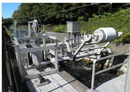
写真-1 UDC Check の外観
