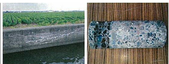
Fig. 3 既設水路の概況及び側壁から採取したコアの状況
