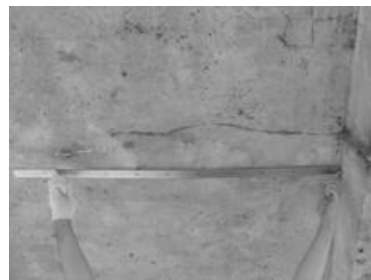
Fig.1 計測対象ひび割れ
