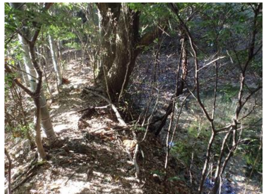
Fig.4 木本類が侵入した堤体(岩ヶ谷上池)
