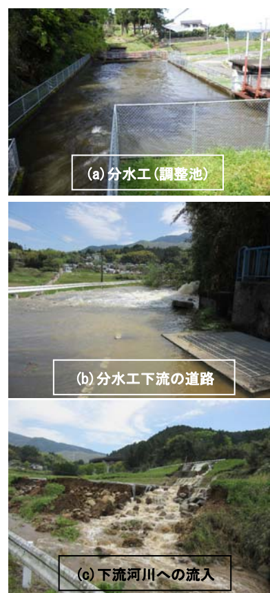
写真 4 下流分水工(調整池)の被害状況
