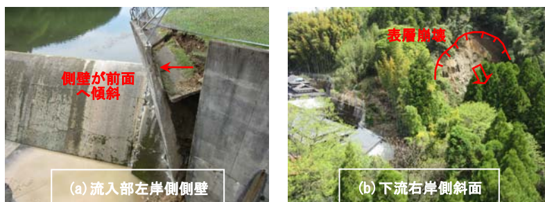
写真 2 洪水吐の被害状況
