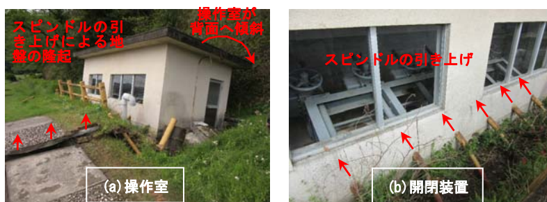
写真 3 斜樋の被害状況
