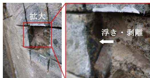
Fig.4 コンクリート内部の浮き・剥離 Delamination of inside concrete
