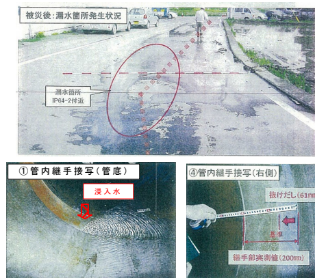
写真-1 IP.64-2 の漏水・計測状況
