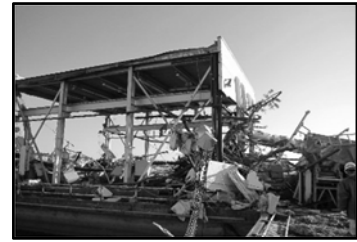
写真-1 鉄骨だけが残っているケース
