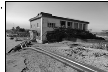
写真-2 建屋の原形を留めているケース
