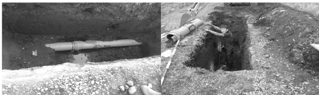
写真-1 パイプの地下での被災状況
