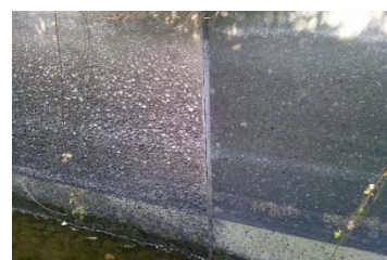
写真 2 異なる水路の変状
