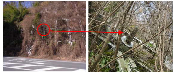
写真1 アンカー破断時の現場状況
