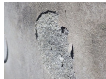
写真-3 被覆材表面の薄層
