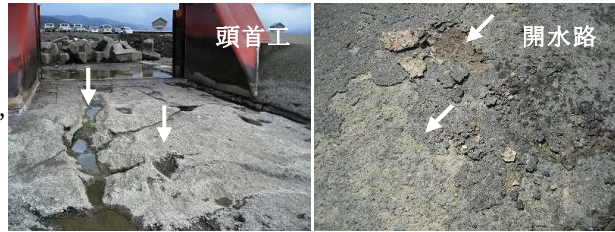
エプロンの変状 底板の変状
