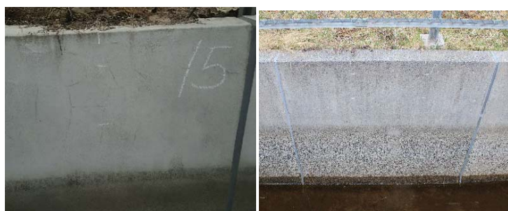
写真-2 Bタイプ(ひび割れ)
