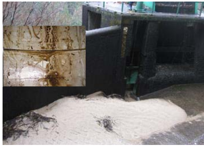
Pic.1 導水管下流に流下した堆積砂管底に摩耗はあるが性能に影響なし
