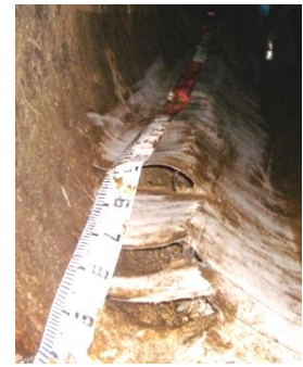
Fig.1 管底部破壊の様子
